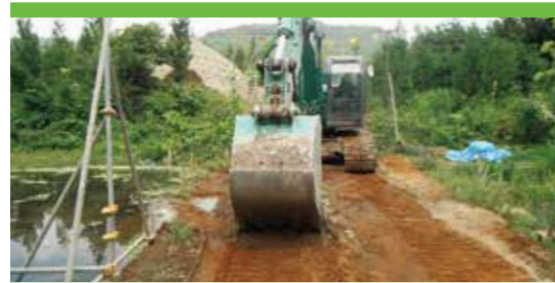
路面整地作業 (路面を平坦にして合板の歪み等を防止します。)
